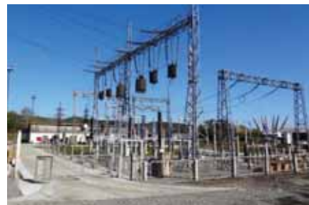
Подстанция в Макарове
