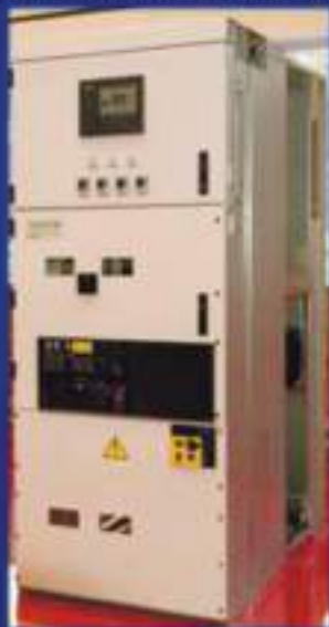
КРУ 6-10 кВ MCSet по лицензии Schneider Electric
