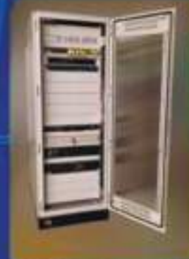
Шкаф серверный передачи данных
