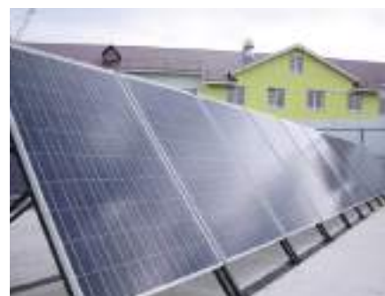
Рис. 8. Площадка солнечных панелей энергоэффективного дома в г. Рыбном, Рязанская обл.
