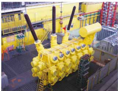
Блочный трансформатор типа ТДЦ-630000/500-У1
