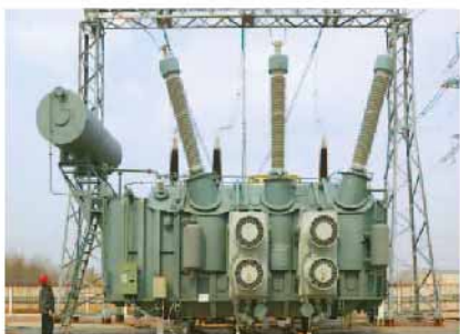
Автотрансформатор типа АТДЦТН-125000/330-У1
