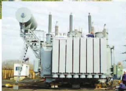
Автотрансформатор типа АТДЦТН-250000/220
